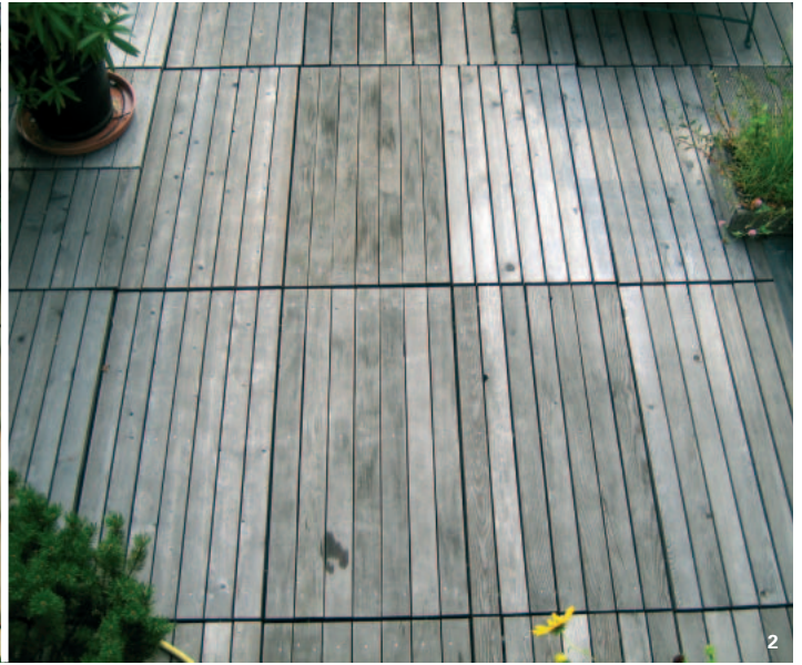
2 Terrassenfläche mit unterschiedlichen Holzarten im Neuzustand und nach einem Jahr Bewitterung
